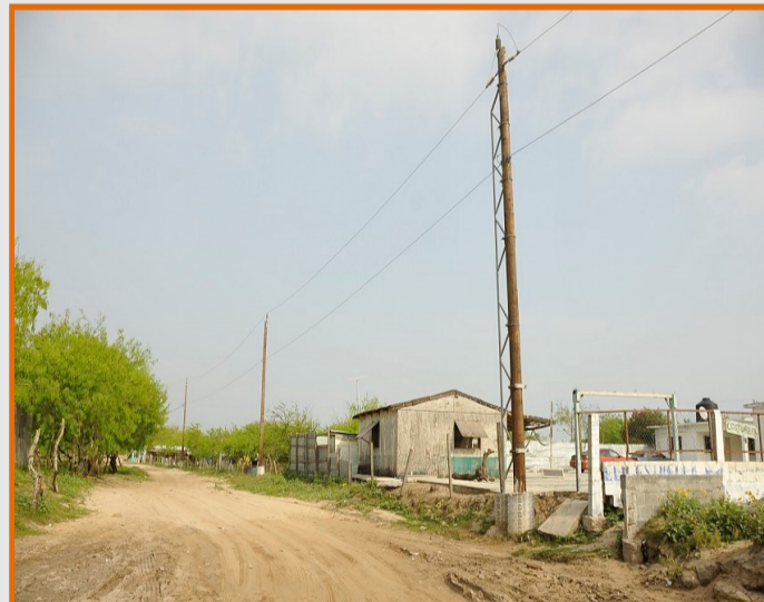
Infraestructura eléctrica en un ejido
