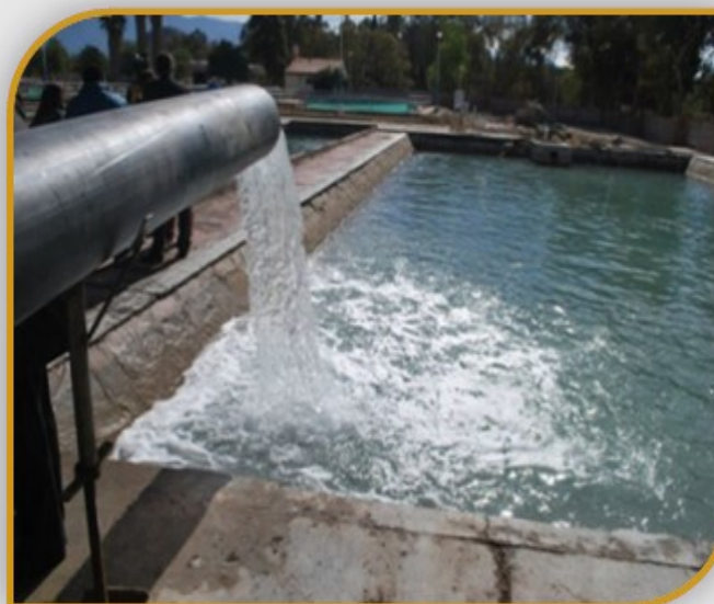
Planta de bombeo
