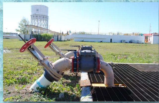
Planta potabilizadora de Reynosa
