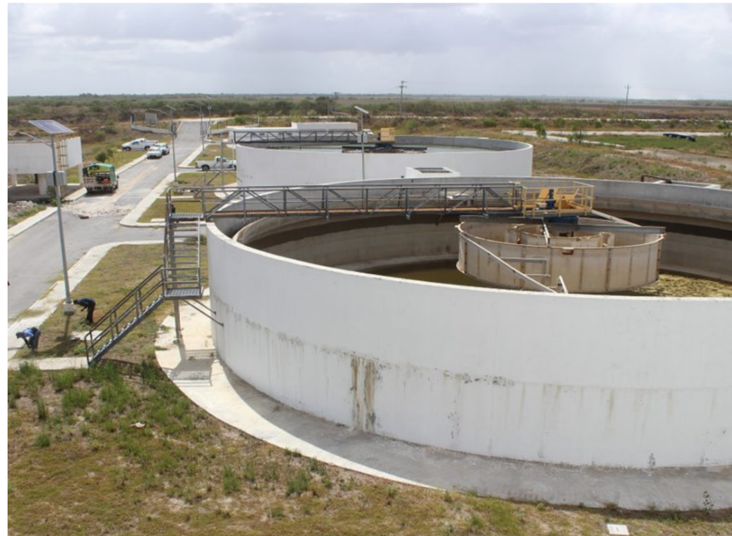
PTAR Oeste; al fondo el dren Principal
